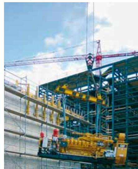
Einer der 69-Liter-Gasmotoren von 1,2 MW beim Einbringen in die neue Energiezentrale von Rolex SA, Genf
