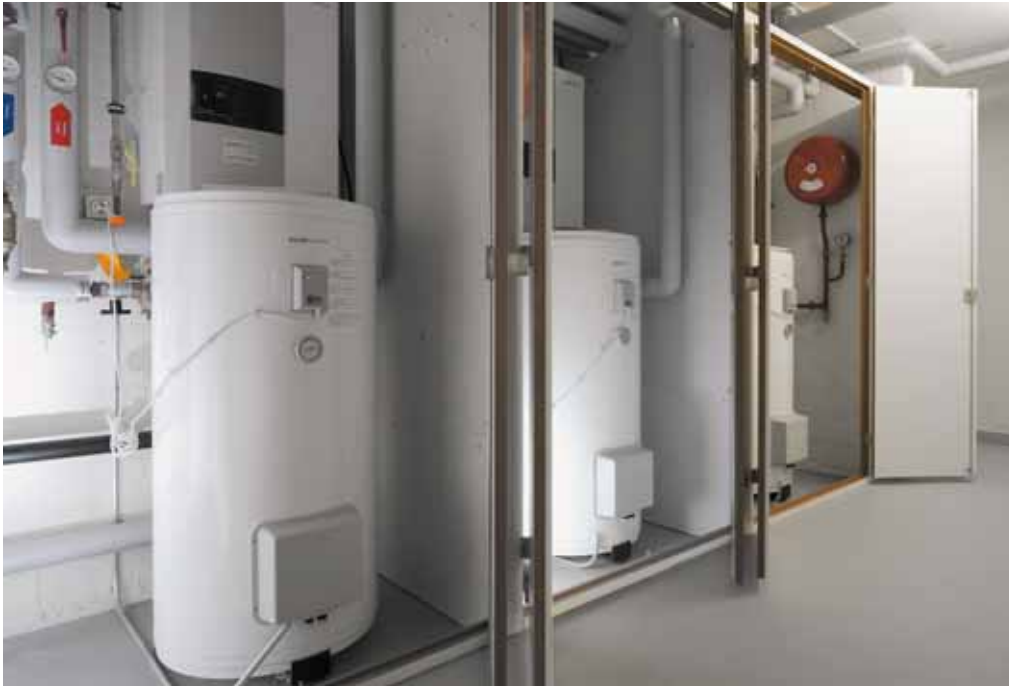
Für jede Wohnung ein modulierender Gas-Kondensations-Wandkessel und ein Beistellboiler in einem Schrank im Keller
