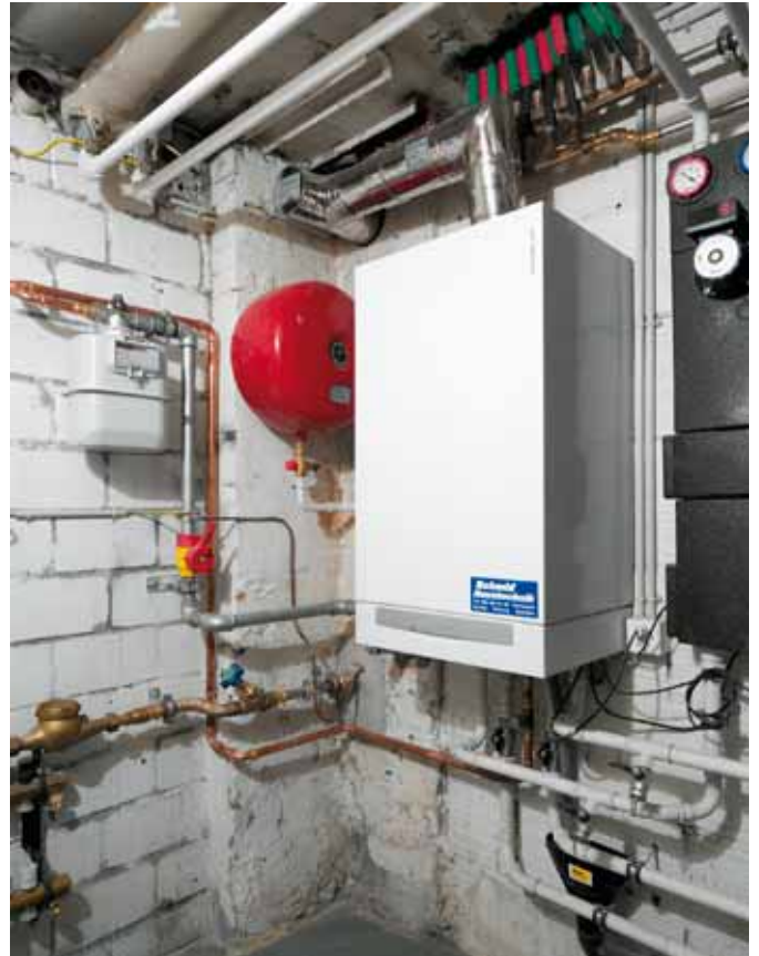
Der neue Gas-Kondensations-Wandkessel braucht wenig Platz. Gas-Zuleitung im modernen Pressfitting-System
