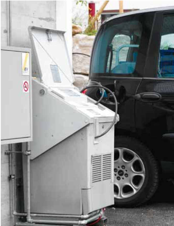
Die Fuelmaker-Erdgas-Tankstelle, daneben der Kasten mit dem Gaszähler
