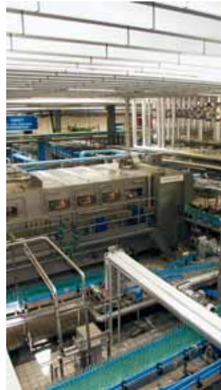
Blick in die Flaschenreinigungs- und Abfüllanlage
