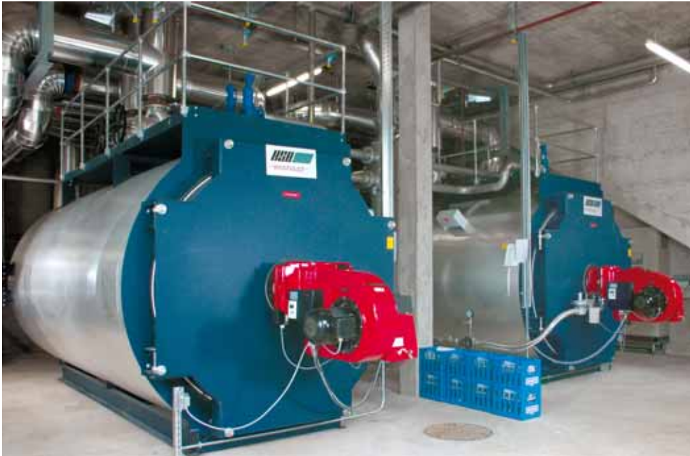
Die beiden neuen 2,5 MW-Heisswasserkessel mit modulierenden Gas-Gebläseburnern
