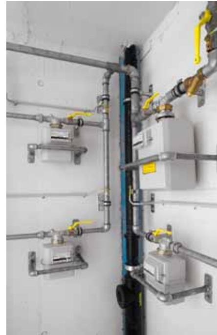
Verbrauchsabrechnung über Gaszähler für jede Wohnung in einem separaten Kellerschrank
