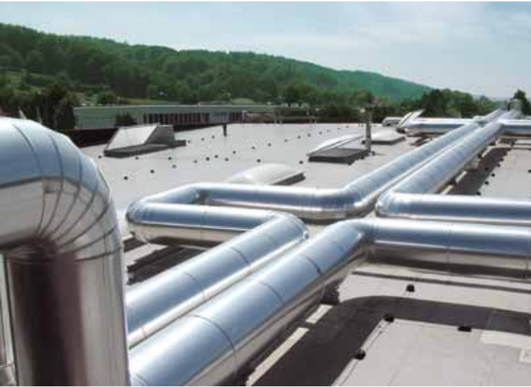
Die Heisswasserverteilung über dem Dach der Fabrikhallen mit den Dilatationsschlaufen
