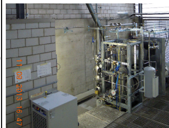
Testanlage BF15 in Bachenbülach
