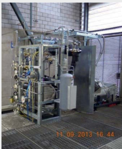
Fig. 11 Die Blue FEED BF15 in Bachenbülach Le Blue FEED BF15 à Bachenbülach
