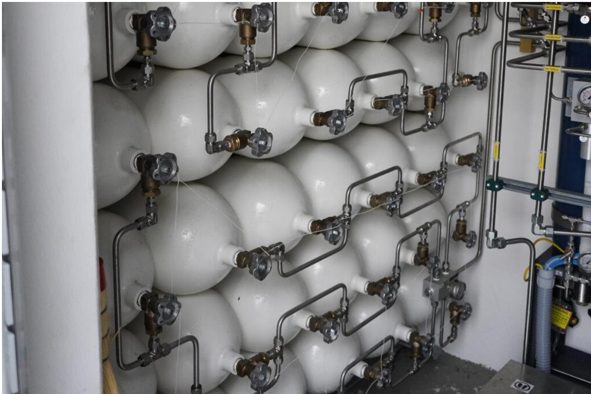
Das dreistufige Kaskadenbetankungssystem im Aargauer Betonhäuschen. Quelle: CNG-Mobility.ch
