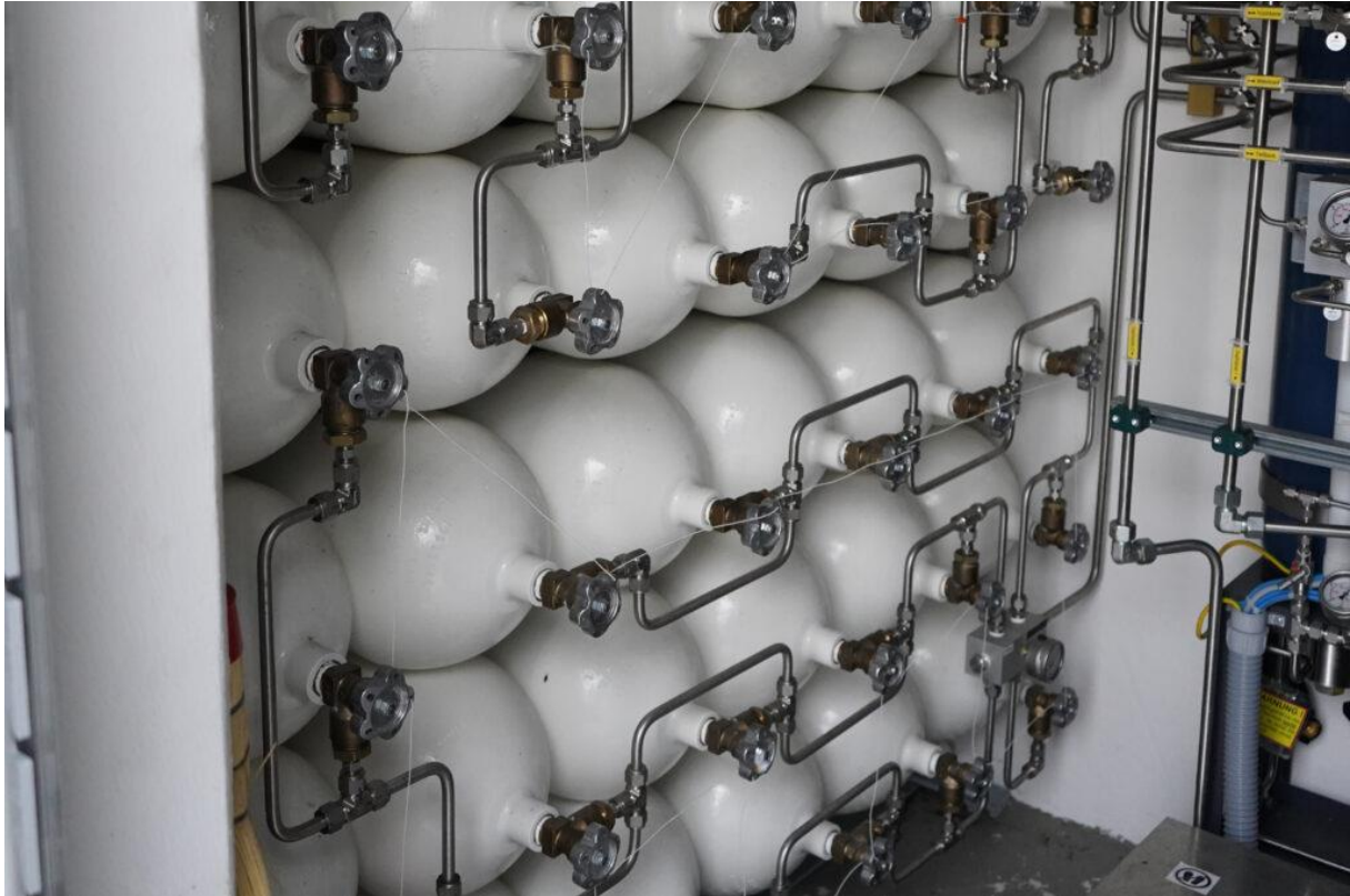
Le système de ravitaillement en cascade en trois étapes dans la maison en béton en Argovie. Source : CNG-Mobility.ch
